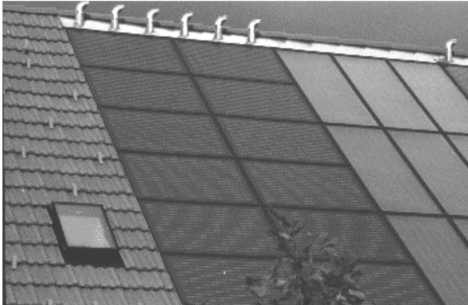
Figuur 4.17 De fotovoltaïsche modules laten zich ook gecombineerd met zonnethermische collectoren in de dakschaal van een woning integreren. Ze kunnen zoals hier volledig de waterkerende functie van de dakpannen overnemen (© 1994 The Swiss Federal "Promotion Program for PV"- TNC Consulting AG, CH-8708 Mannedorf).
