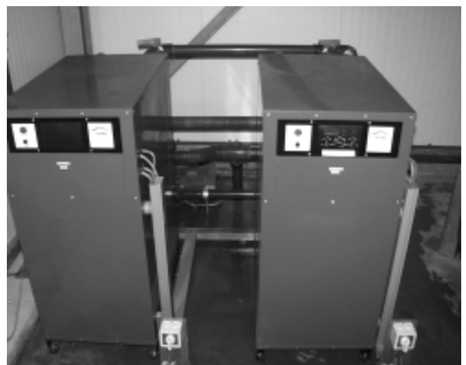
Figuur 11.1 Warmtepompen voor klimatisering (koelen/verwarmen) van gebouwen
